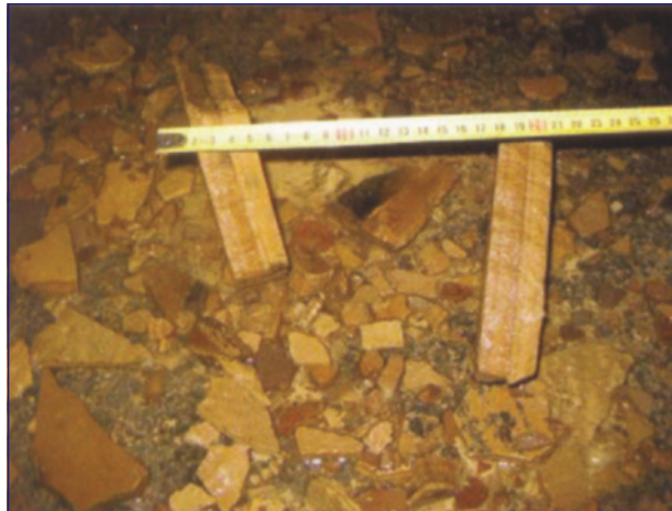
شکل شماره ۱۱: تکه‌های سخت آهک به دلیل نظافت ناکافی
