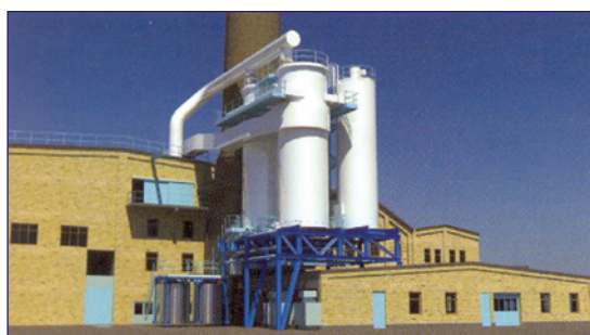
شکل شماره ۹: ایستگاه فیلتراسیون (صافی) برای جداسازی گردوغبار
